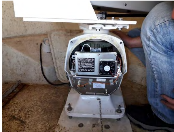
Head-Unit nueva instalada en el radar GUAXX
